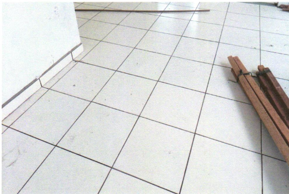
FOTO 17 - REVESTIMENTO CERÂMICO PARA PISO COM PLACAS TIPO ESMALTADA EXTRA DE DIMENSÕES 45X45 CM APLICADA EM AMBIENTES DE ÁREA ENTRE 5 M2 E 10 M2. AF_06/2014
